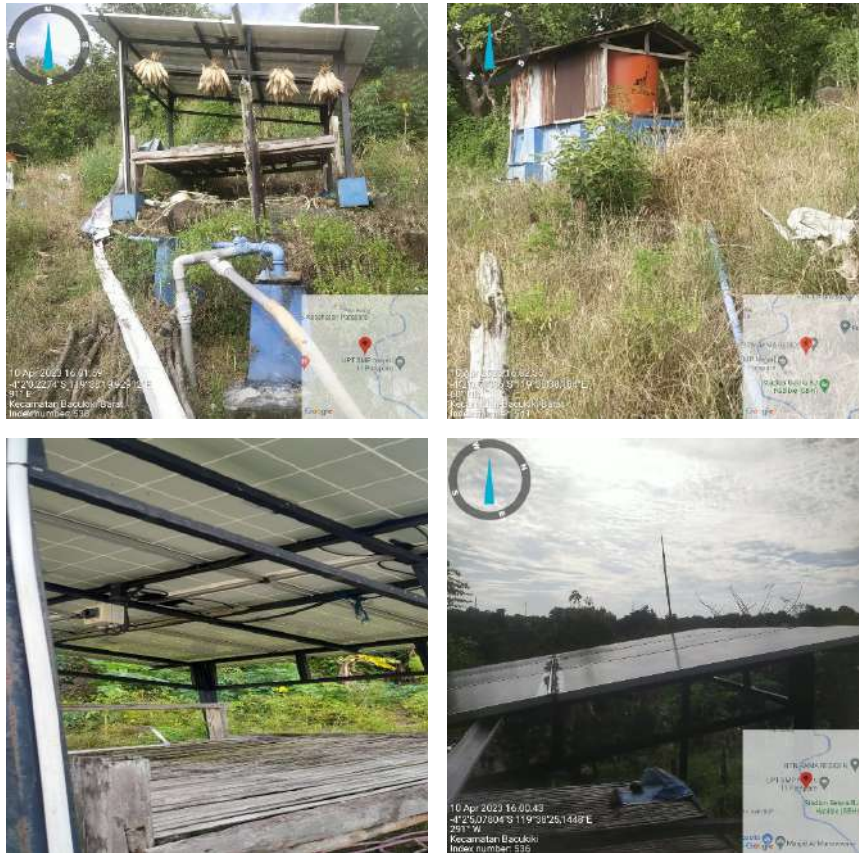
Gambar 2. Instalasi tenaga surya milik mitra yang terbengkalai dan tidak difungsikan.
