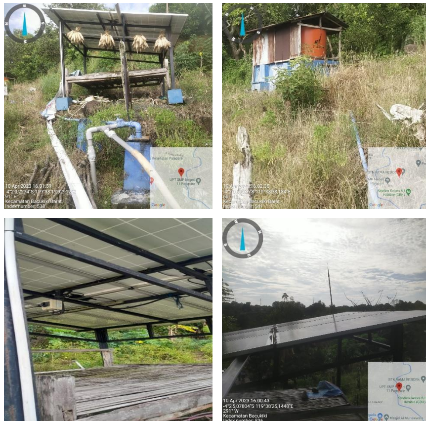
Gambar 2. Instalasi tenaga surya milik KT Barangan yang dibangun oleh Dinas Pertanian Kota Parepare terbengkalai dan tidak difungsikan secara maksimal.
